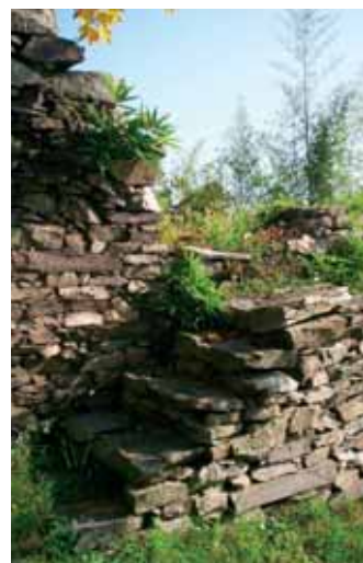
Fig. 6 - Scala in sasso tra i terrazzamenti della villa "Il Sasso" frazione Oggiogno
